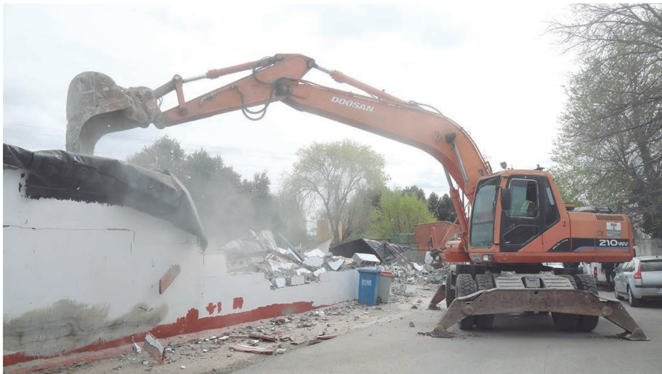
Momento en que una excavadora derriba una de las construcciones ilegales, el pasado 18 de marzo. PACO MARISCAL
